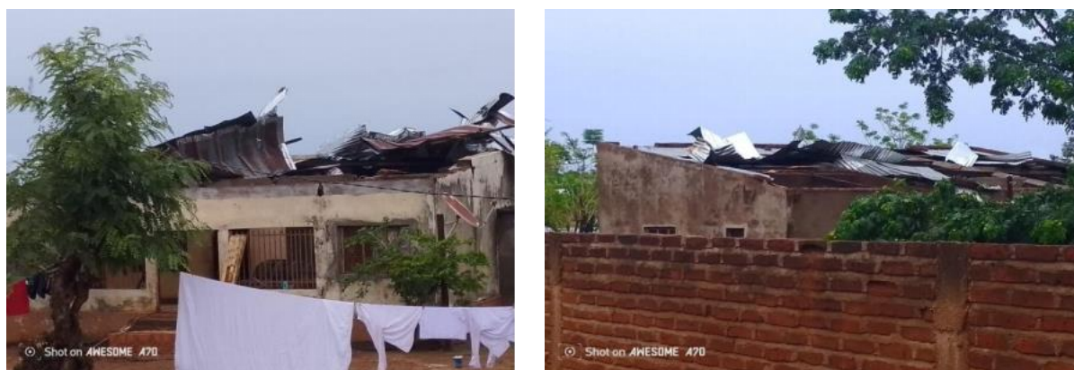
Figura 4 – Residências atingidas pelo vendaval, destruindo tetos
