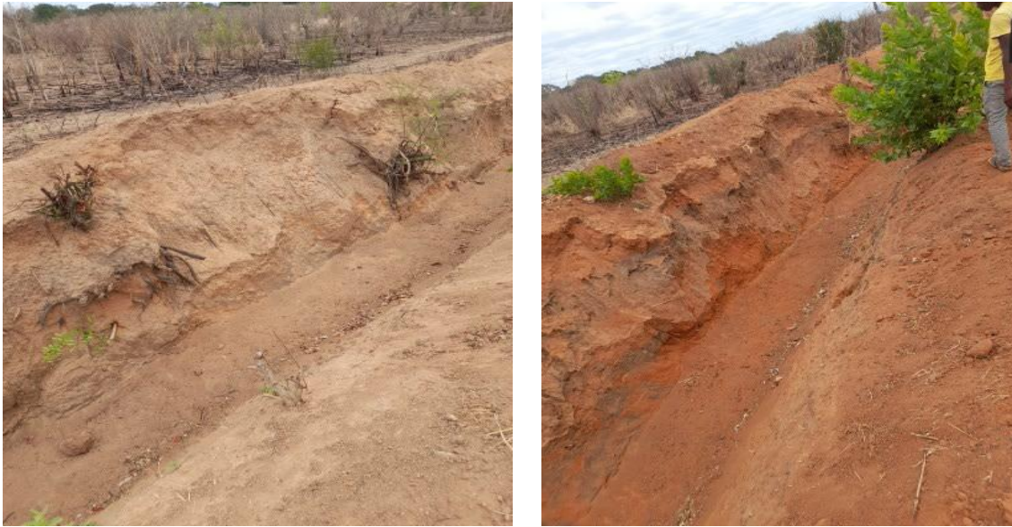
Figura 2 – Paredes da trincheira sofrendo de erosão
